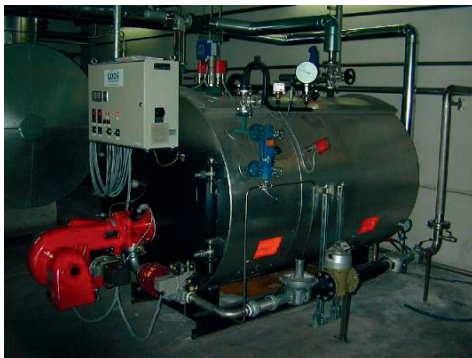
Abbildung 6: Dampfkessel zur Biogasverbrennung
