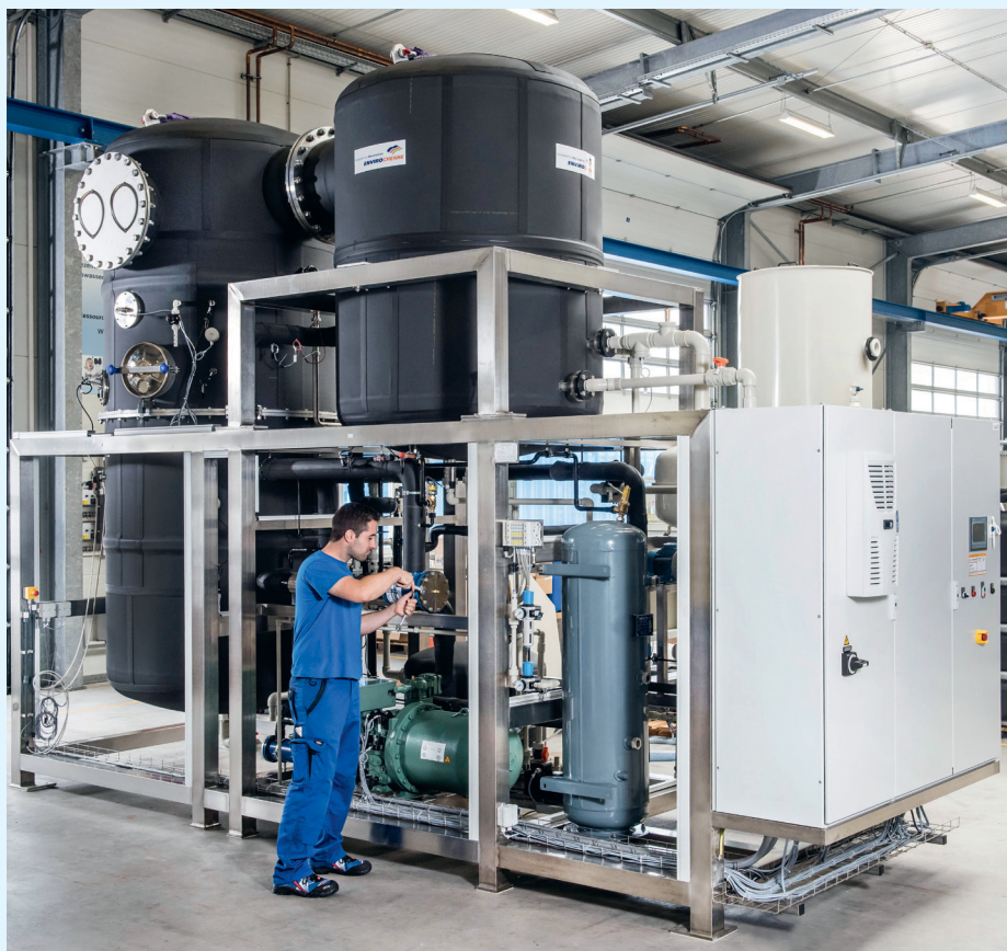
Bild 3 Häufig werden für ZLD Verdampfer wie der Envirochem Evaporator eingesetzt, die das verbliebene Wasser verdampfen oder entfernen.
